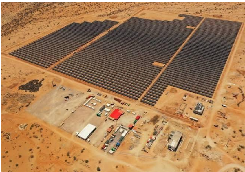
Figura 7 – Vista dos módulos fotovoltaicos instalados na Central Fotovoltaica de Caraculo, Namibe – Angola [4]
