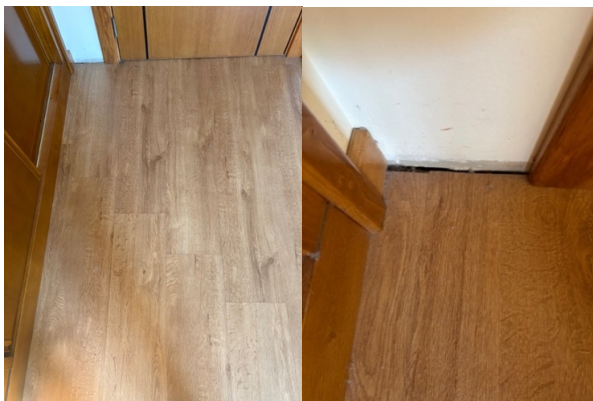
Figura 14: Defeitos no Piso Laminado
