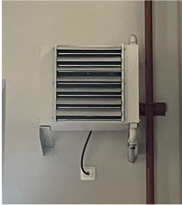
Figura 74- Aerothermo de pared en taller de planta baja. Fuente: Elaboración propia.
