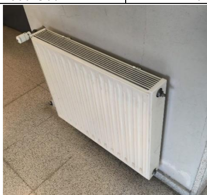
Figura 12- Tipo de radiador de la instalación del CITENI. Fuente: elaboración propia.
