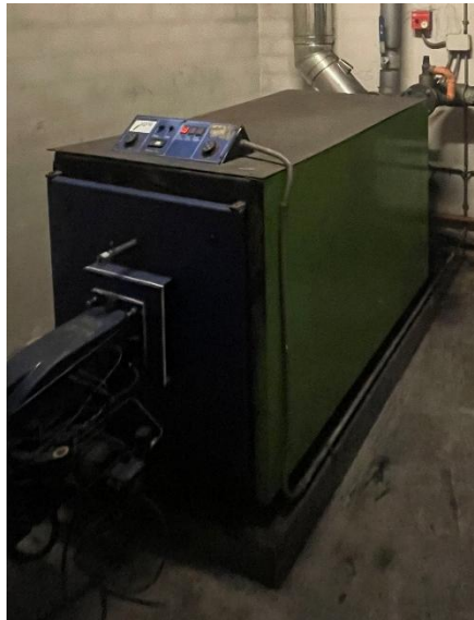
Figura 11- Caldera de gasoil del fabricante Baxi-Roca modelo NTD-260. Fuente: elaboración propia.
