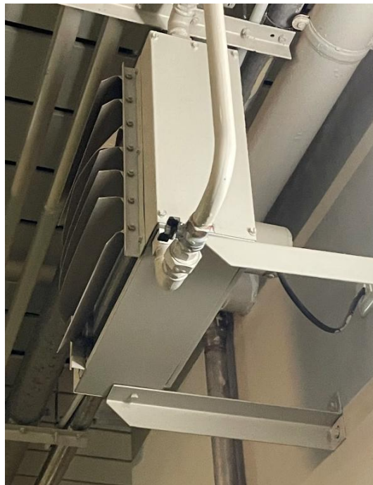
Figura 73- Aerotermo de pared en canal de ensayos de planta semisótano. Fuente: Elaboración propia.
