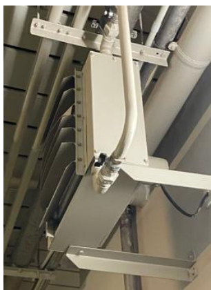
Figura 13- Tipo de aerotermo de la instalación del CITENI. Fuente: elaboración propia.
