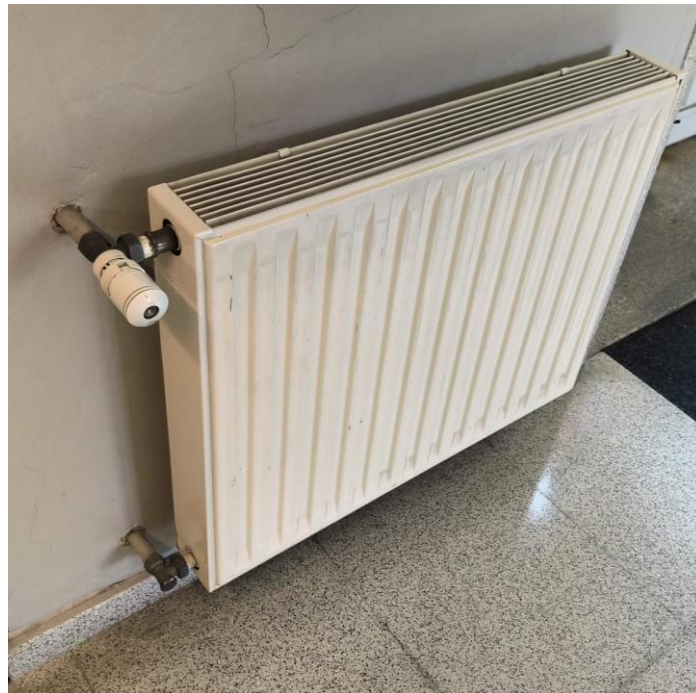
Figura 75- Radiador en vestíbulo general en planta baja. Fuente: Elaboración propia.
