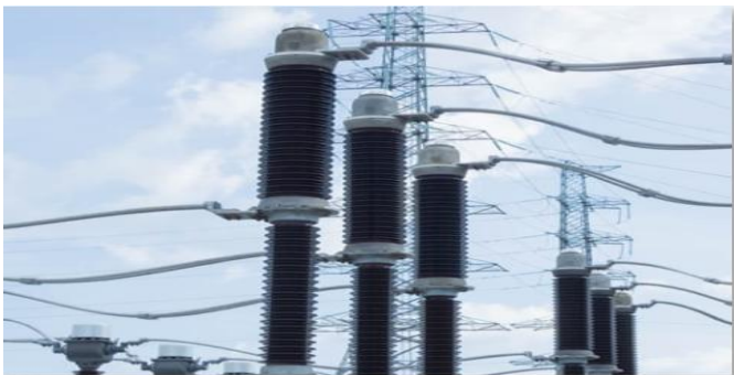
Figura 18 - Disjuntor do grupo.
