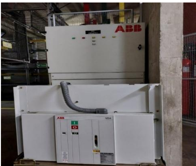
Figura 19 - Disjuntor de alternador.
